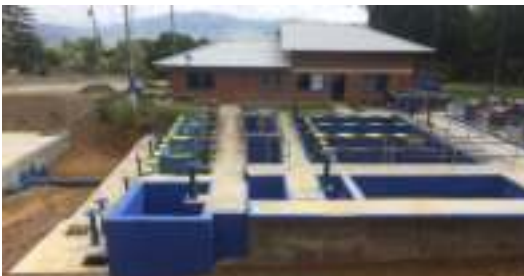
NUEVA LINEA DE TRATAMIENTO CONSTRUIDA COMPRENDE FLOCULACION, SEDIMENTACION,
