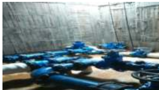
VALVULAS INSTALADAS A LA SALIDA DEL TANQUE DE ALMAENAMIENTO.
